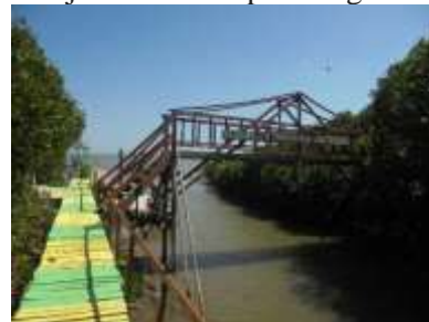
Gambar 8. Kondisi jembatan pelangi
